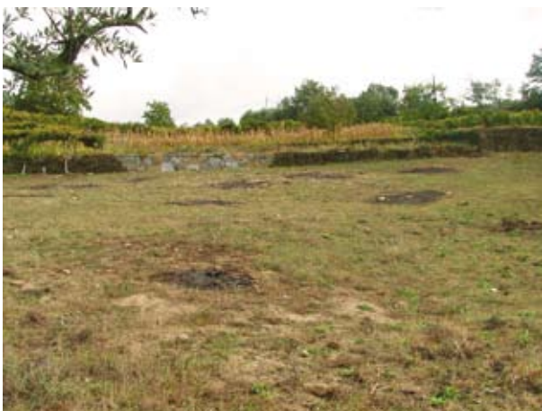
Fig.4 - Vista de jusante do local da cicatriz do fluxo de Santa Marinha do Zêzere em 2004, após a reconstrução dos patamares agrícolas
